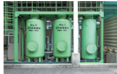
砂ろ過・活性炭吸着塔
