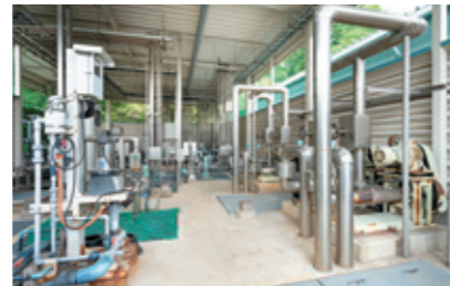
浸出水処理設備
